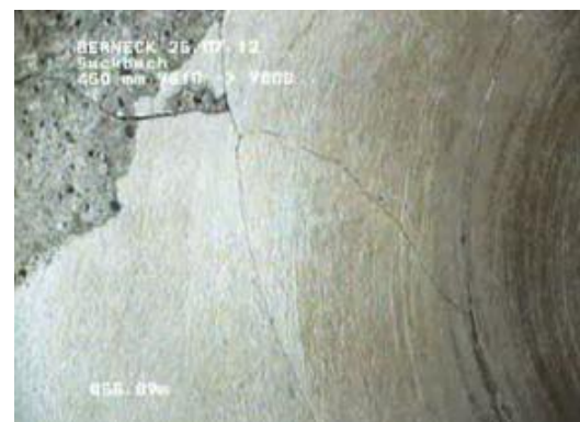
Risse und Abplatzungen
