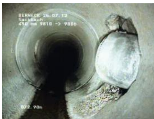
unsachgemässe ausgeführter Einlauf
